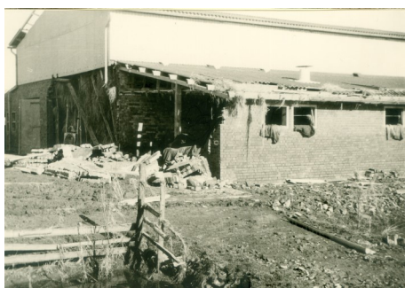
Zerstörungen auf der Hofstelle Heinsohn (PL)
